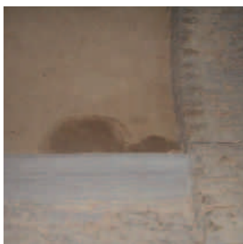
Degoters de coberta que es veuen a la volta principal.
