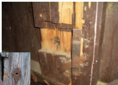
Porta a façana W, de fusta, s.XVIII, amb agressions recents de "brètols". Han trencat el pany, per la qual cosa s'ha d'apuntalar la porta per l'interior.
